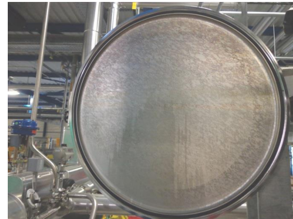
Derouging nach Laugenkorrosion in Zirkulation
