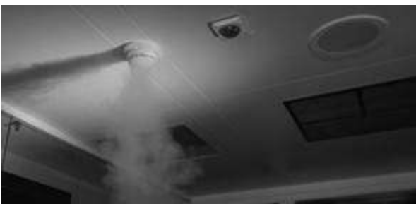
Bild 3: Lecksuche auf der Baustelle an einem fehlerhaft installierten Rauchmelder
